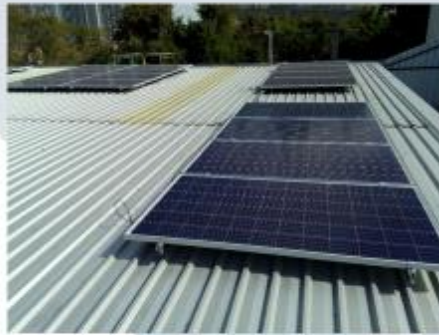
โรงงานแข็งสิริมิตร ขนาด 10 kW
